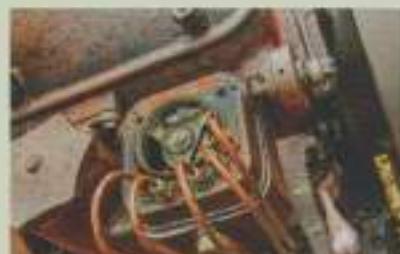
De oliepomp transporteert de smeerolie via koperen leidingen rechtstreeks naar de smeerpunten.
