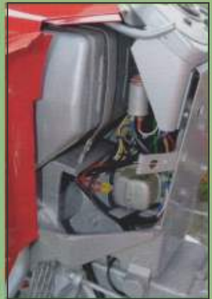
Twee deurtjes rechts en links: overzichtelijk zicht op de compleet vernieuwde elektrische installatie.
